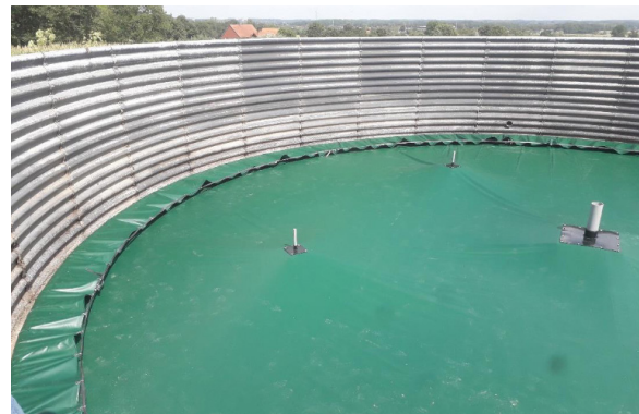
Güllelagerabdeckung mit Schwimmfolie (Quelle: Genap B.V.)
